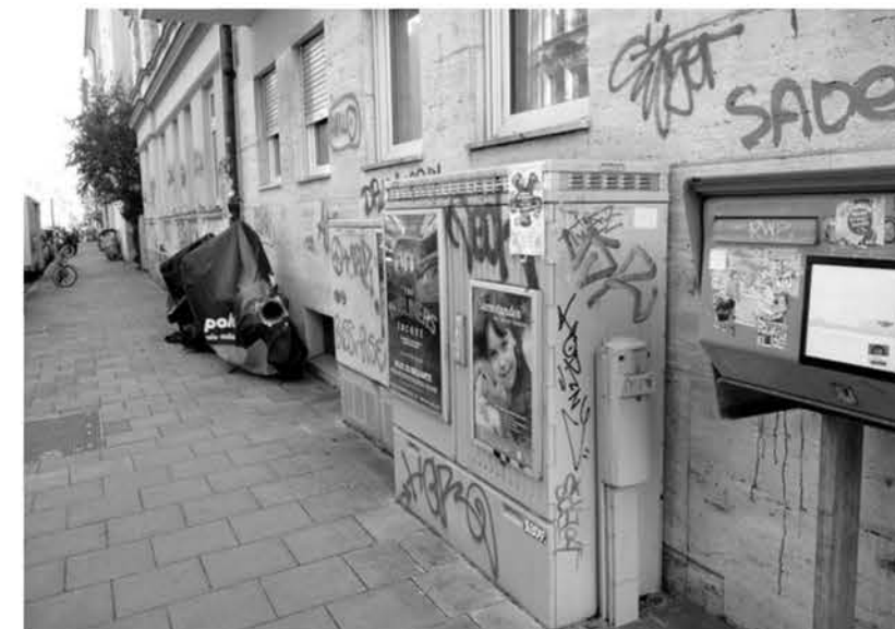
Verteilerkästen in der Metzstraße – bald gibt's etwa fünfzig mehr davon im Viertel.
