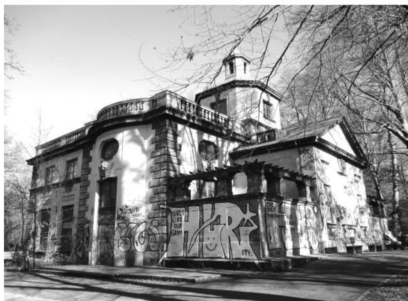
Maxwerk: Die Stadtwerke München sind Hauseigentümerin und vernachlässigen den Bauunterhalt, ablesbar in einer zerbrochenen Fensterscheibe und Schäden an der Bausubstanz. Die Graffiti sind da eher der künstlerische Farbtupfen, ohne die das Gebäude noch trostloser ausschaute.
