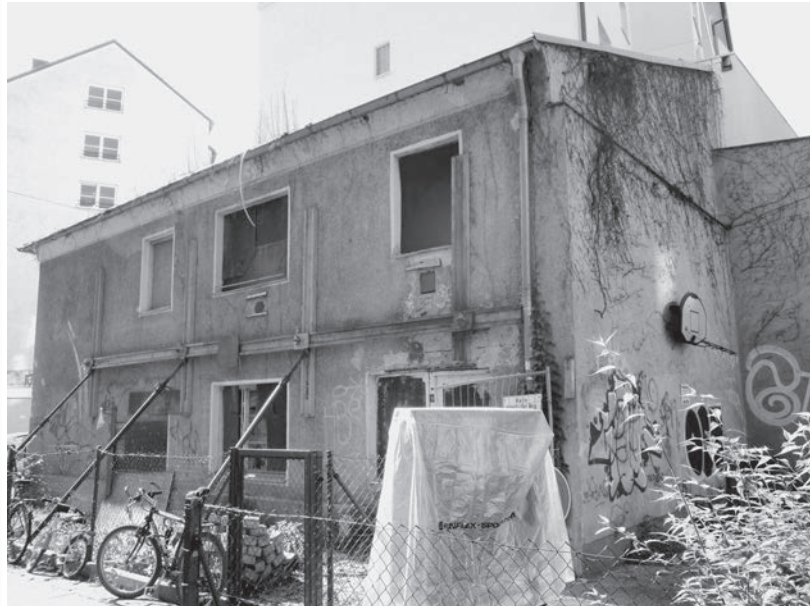
Preysingplatz 8 – leer und baufällig seit vielen Jahren
