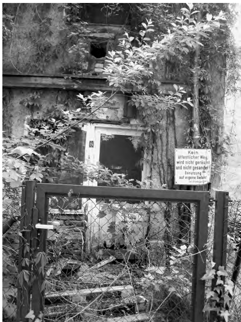
Sinn- und augenfälliger kann die Bedeutung und Beachtung des Denkmalschutzes kaum sein: Das denkmalgeschützte Haus Preysingplatz 8, dessen Zustand nach Beobachtung eines Nachbarn seit 1994 währt, ohne dass die Behörden dem Eigentümer Auflage erteilt haben, Grundstück und Haus zu sichern, besser noch: es wieder herzurichten.
